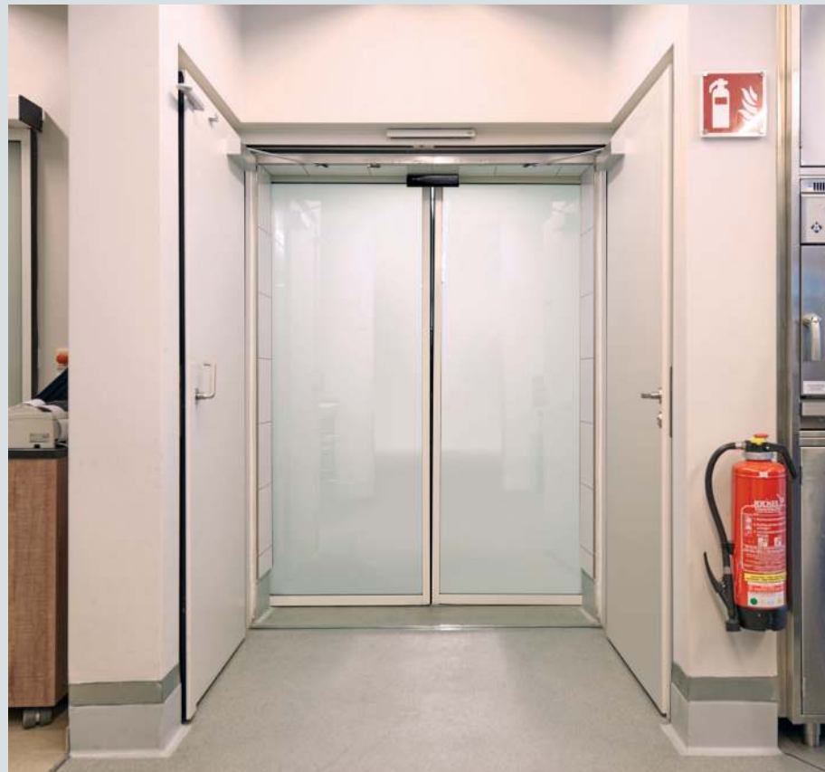
Ansichtsseite Feuer- und Rauchschutztür (Tagbetrieb)
